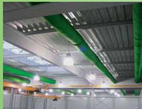
Frische Luft aus grünen Schläuchen. Fresh air of green tubes.
